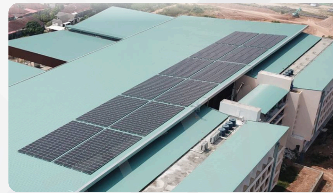
475.20 kWp โรงเรียนมารีย์วิทย ระยอง
