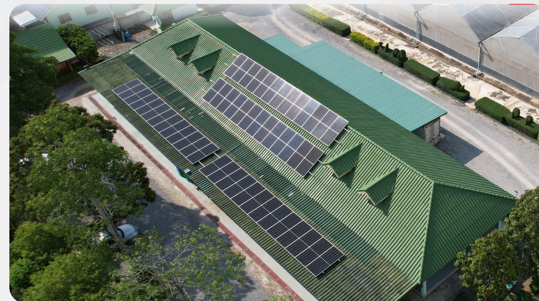
30.68 kWp บ้านไร่ปวริศ
