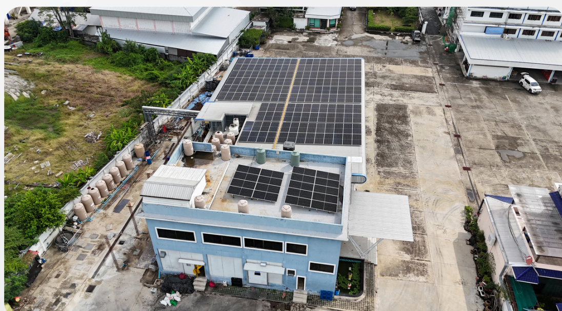
104.72 kWp โรงงานมหาชัยไอศกรีม
