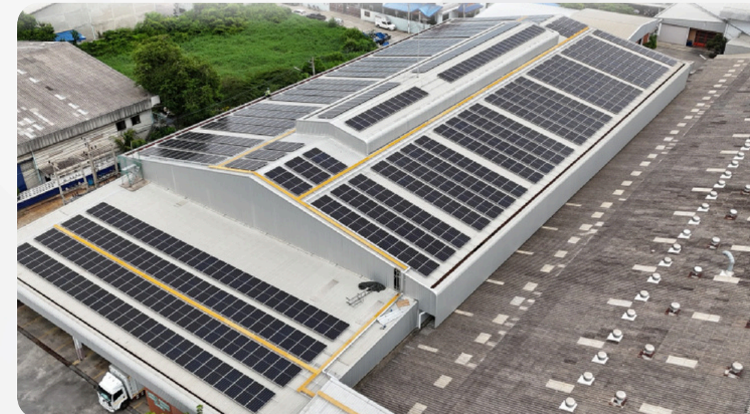
448.80 kWp บริษัท ยูโนเท็ด คอนเทนเนอร์ จำกัด
