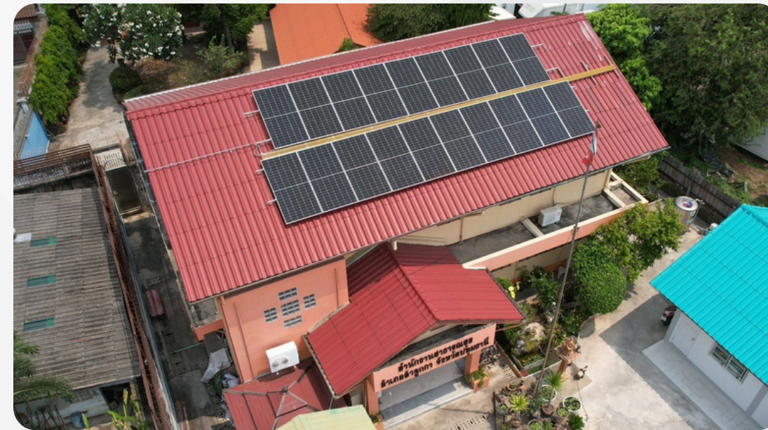
10.45 kWp สำนักงานสาธารณสุข อำเภอลำลูกกา
