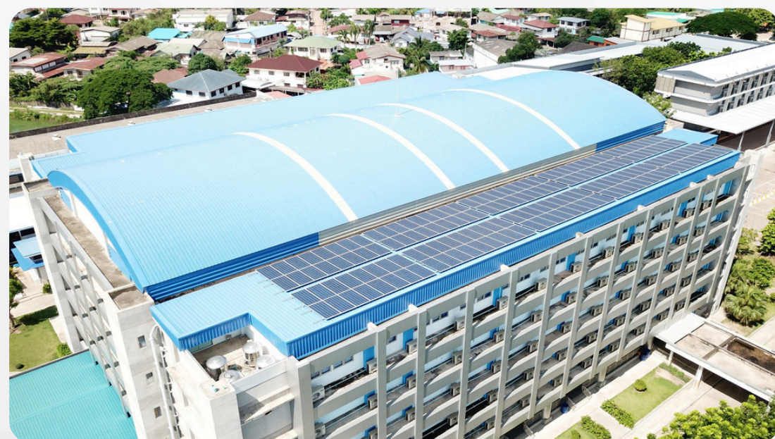
150 kWp โรงเรียนดอนบอสโก อุดรธานี
