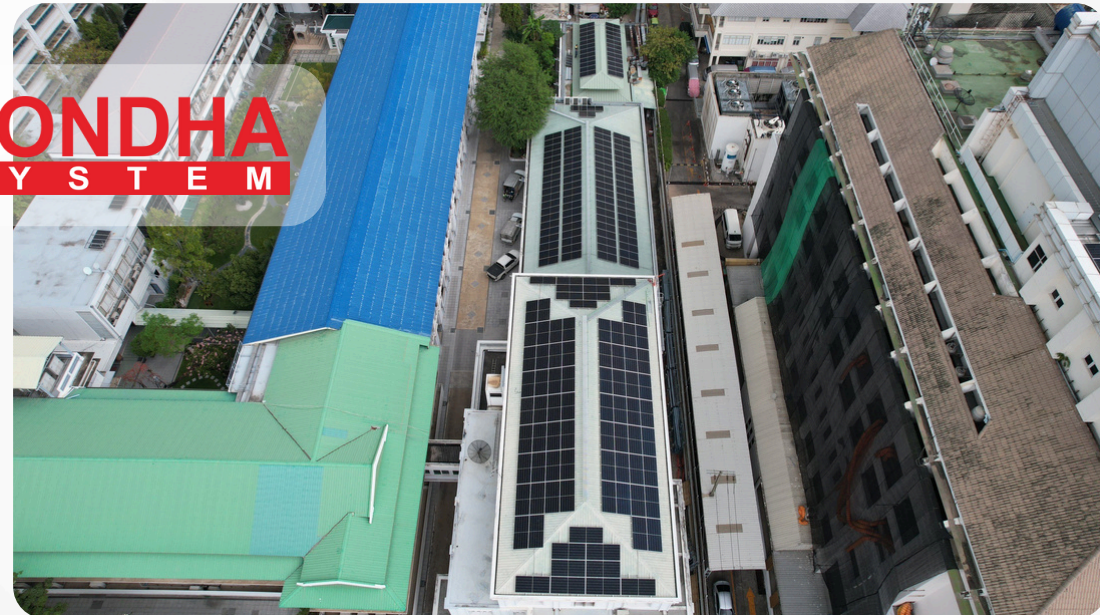
120 kWp โรงเรียนเซนโยเซฟคอนเวนต์ สีลม
