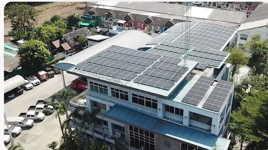
116.64 kWp เทศบาลเมืองบึงยี่โก
