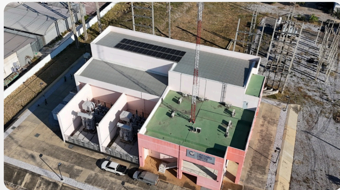
17.36 kWp สถานีไฟฟ้าบางพระครู
