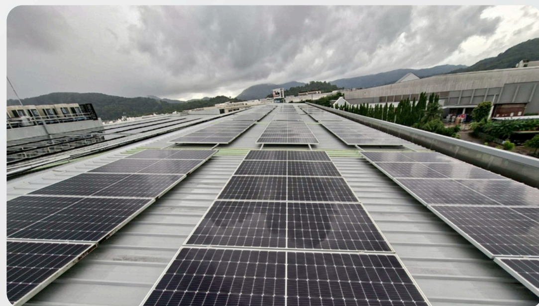
180 kWp โรงเรียนดาราสมุทรภูเก็ท
