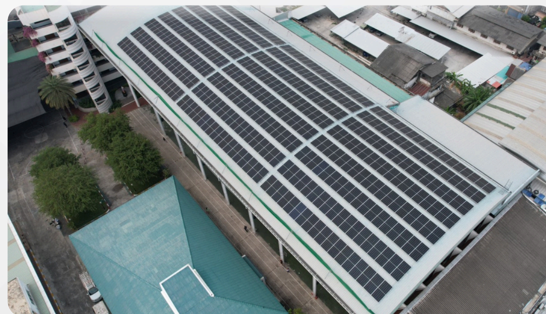
237.60 kWp โรงเรียนปริษานุศาสตร์
